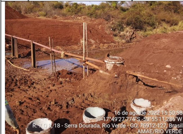
16 de ago de 2022 15:50:58 -17°49'27,774"S - 50°55'11,286"W R. 7 Q 8, 18 - Serra Dourada, Rio Verde - GO, 75912-127, Brasil AMAE/RIO VERDE Autor: AMAE/RIO VERDE Descrição: PV com a altura diminuída de forma a reduzir o risco de desabamento.
