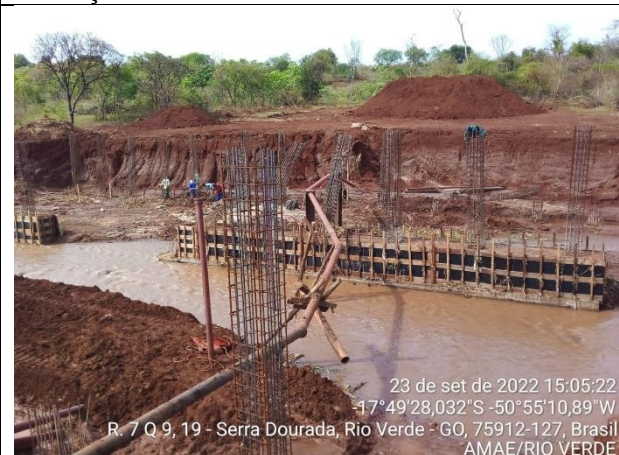
Autor: AMAE/RIO VERDE Descrição: Travessia rompida devido à precipitação
