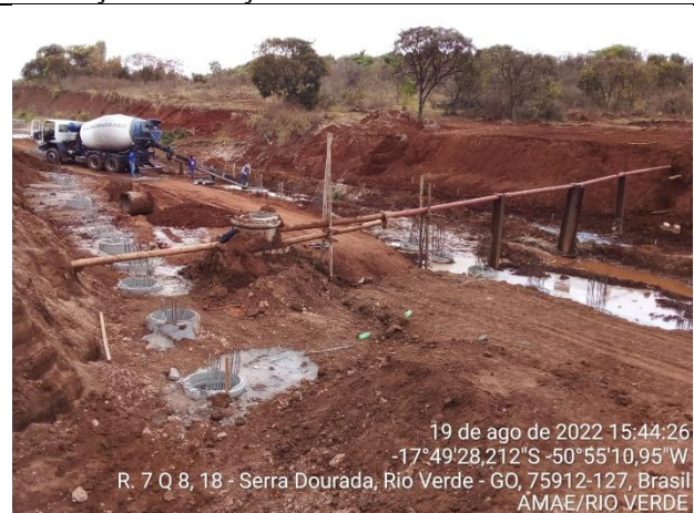
19 de ago de 2022 15:44:26 -17°49'28,212"S - 50°55'10,95"W R. 7 Q 8, 18 - Serra Dourada, Rio Verde - GO, 75912-127, Brasil AMAE/RIO VERDE Autor: AMAE/RIO VERDE Descrição: PV com a altura diminuída de forma a reduzir o risco de desabamento.
