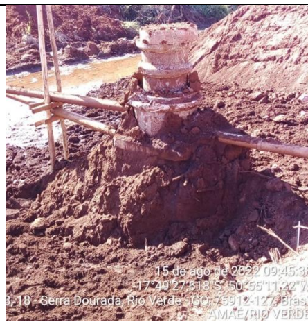
15 de ago de 2022 09:45:33 -17°49'27,618"S - 50°55'11,122"W R. 7 Q 8, 18 - Serra Dourada, Rio Verde - GO, 75912-127, Brasil AMAE/RIO VERDE Autor: AMAE/RIO VERDE Descrição: PV descoberto pelas escavações no seu entorno.
