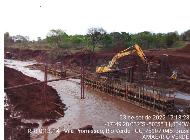
Autor: AMAE/RIO VERDE Descrição: Equipes da BRK trabalhando nos reparos da travessia, rompida devido à precipitação.
