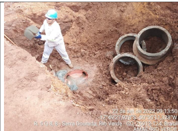
Autor: AMAE/RIO VERDE Descrição: Ramal do PV instalado.
