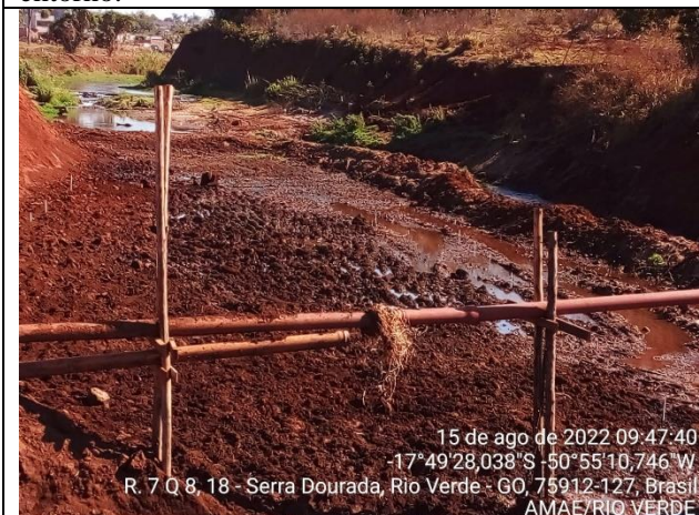
15 de ago de 2022 09:47:40 -17°49'28,038"S - 50°55'10,746"W R. 7 Q 8, 18 - Serra Dourada, Rio Verde - GO, 75912-127, Brasil AMAE/RIO VERDE Autor: AMAE/RIO VERDE Descrição: Detalhe do escoramento improvisado.
