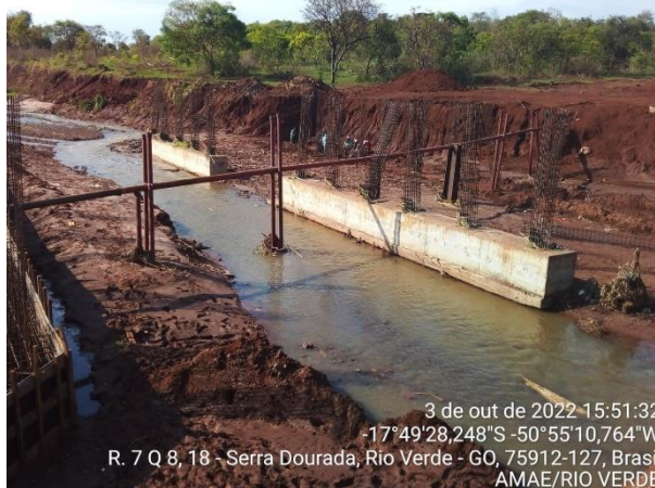
Autor: AMAE/RIO VERDE Descrição: Equipes da BRK trabalhando nos reparos da travessia, rompida devido à precipitação.
